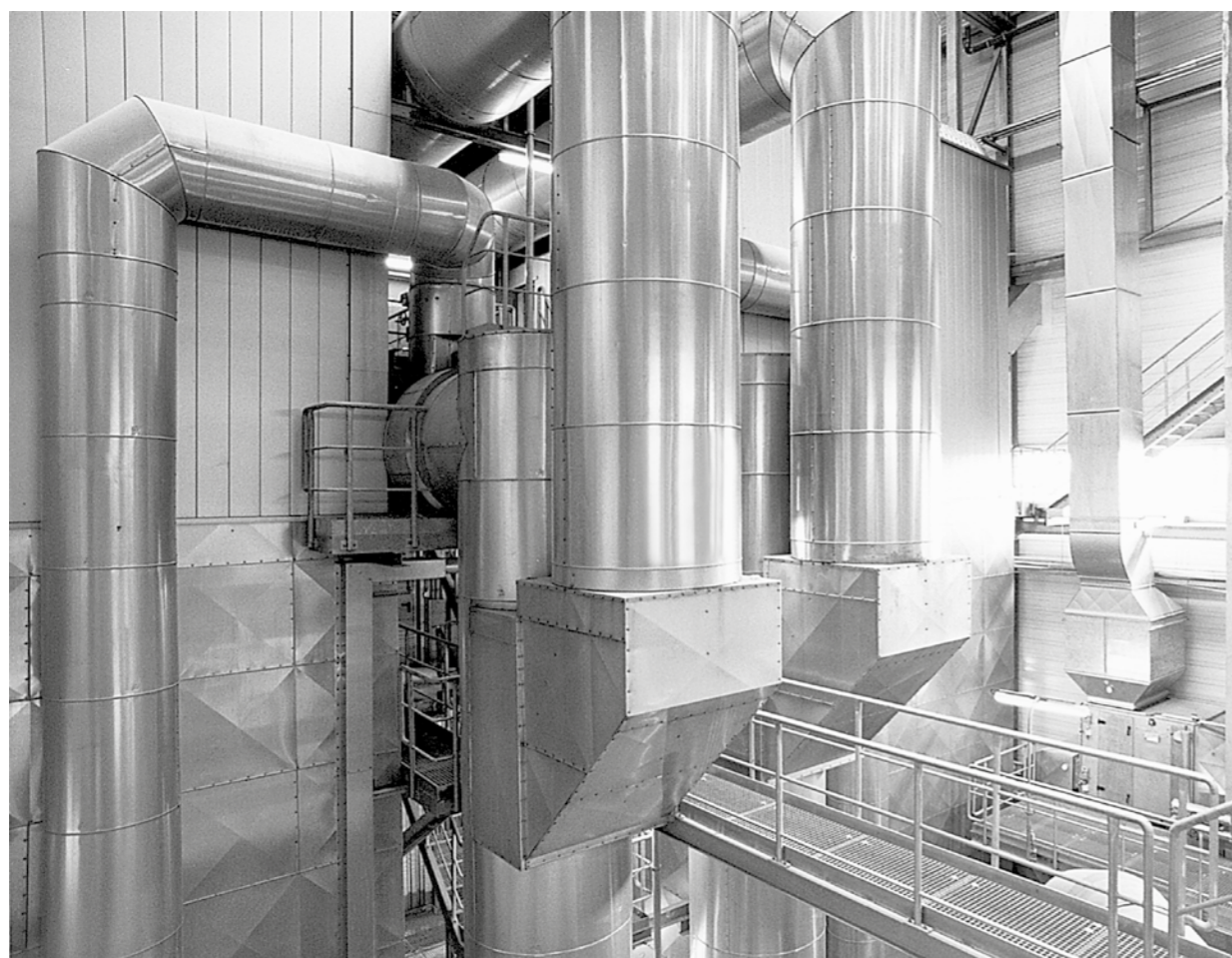
Foto: AWB – Blick auf den Gewebefilter
